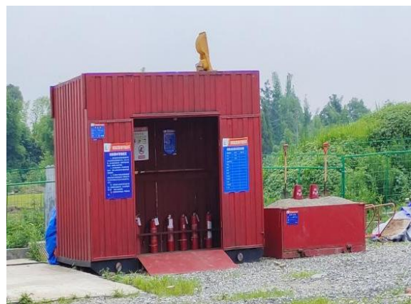
钻井期间消防沙、灭火器
