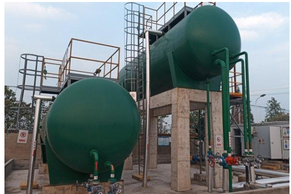
储水罐和高架注水罐
